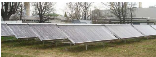
Beispielfoto Solarthermie-Kollektoren. KoLas Kollektoren brauchen eine Standfläche von 1.700 m 2 .
